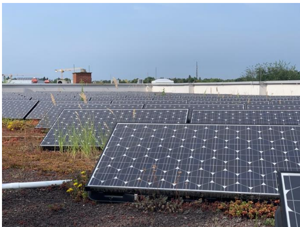
ABBILDUNG 6 Photovoltaikanlage auf dem Dach
